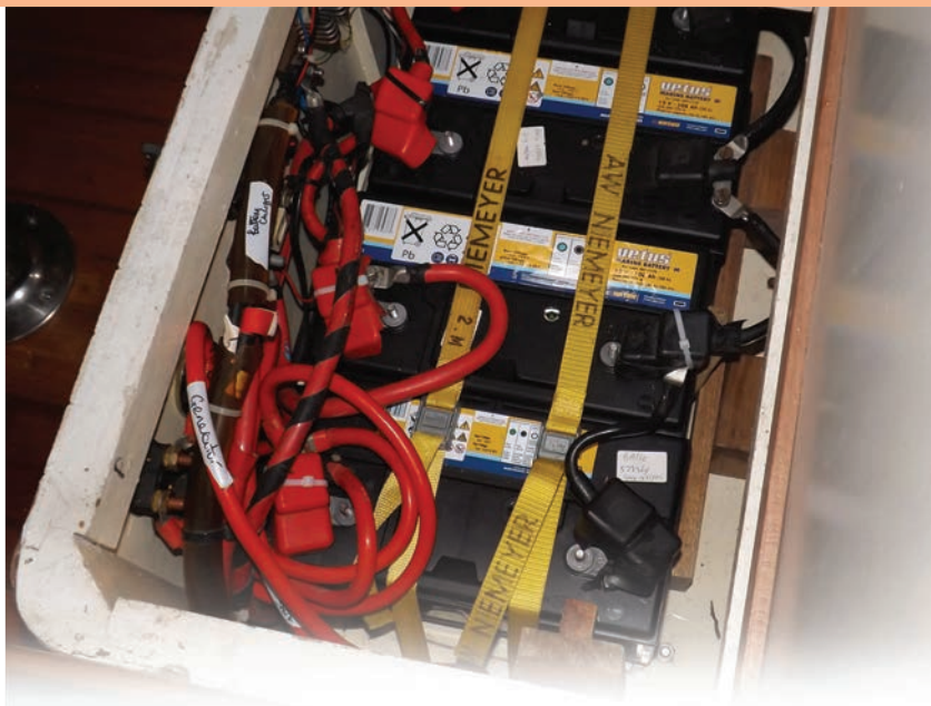
Die Batterien bilden das Herzstück des Bordnetzes. Hier ist die gesamte Energie gespeichert und stets abrufbereit.
