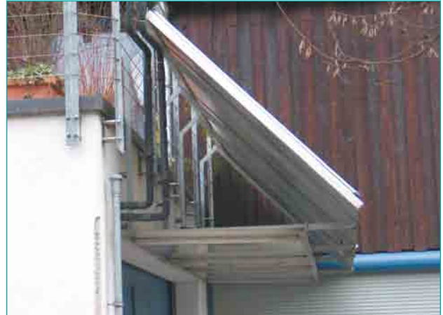
Abb. 77 – Brüstungskollektoren als guter gestalterischer und technischer Abschluss einer Terrasse.
