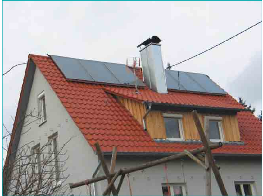
Abb. 1 – Solarthermie im Altbau.
