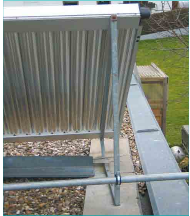
Abb. 74 – Thermische Solaranlage auf dem Flachdach aufgestellt. Dieser Selbstbauer hat als Unterlage Betonrandsteine verwendet und das Gestell einfach darauf gestellt.
