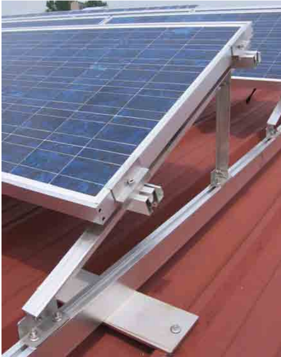
Abb. 4.12: Mit Ständern hochgestellte Solarmodule auf einem Flachdach. (Foto: Schletter)
