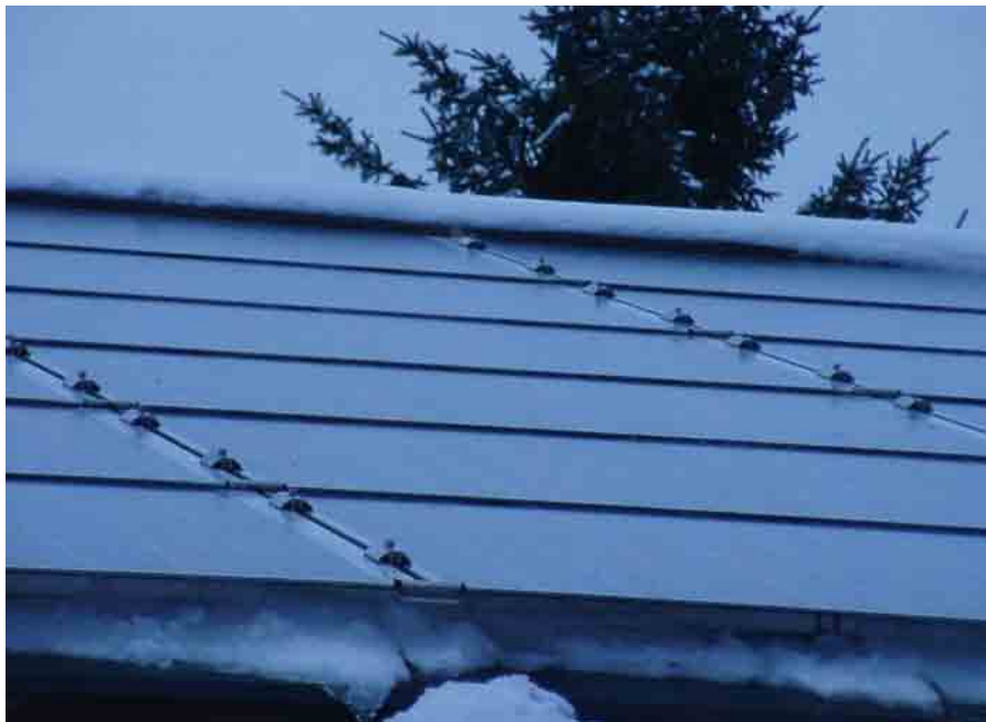
Abb. 4.11: Das zusätzliche Gewicht durch Schnee, das auf den Modulen lastet, kann vor allem in schneereichen Gebieten enorm sein. (Foto: Schletter)
