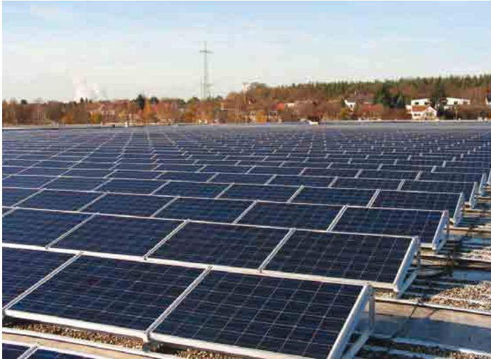
Abb. 4.16: Mit Kies beschwerte Wannengestelle tragen die Solarmodule. (Foto: Conergy)
