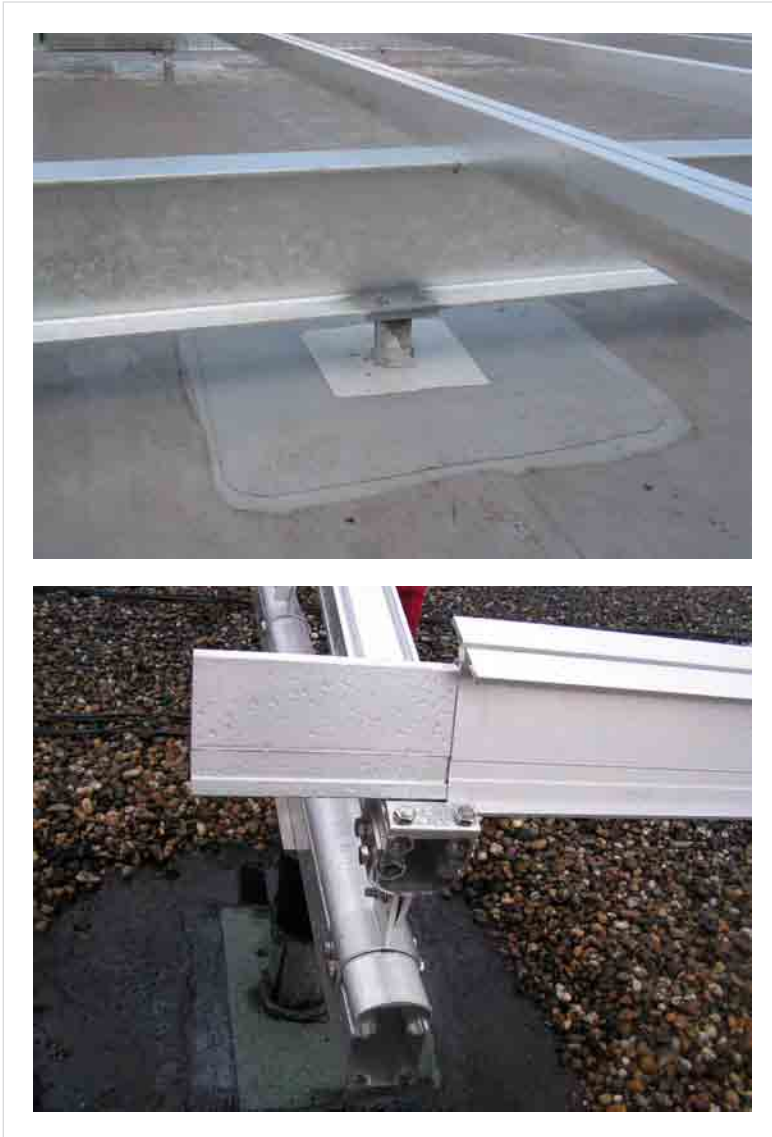
Abb. 4.17: Unterkonstruktionen von Photovoltaikanlagen, die fest mit dem Flachdach verbunden sind. (Fotos: Schletter)
