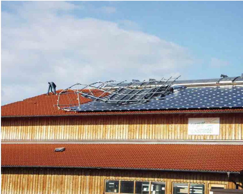
Abb. 4.9: Sturm hat bei schlecht gesicherten Modulen leichtes Spiel. (Foto: Schletter)
