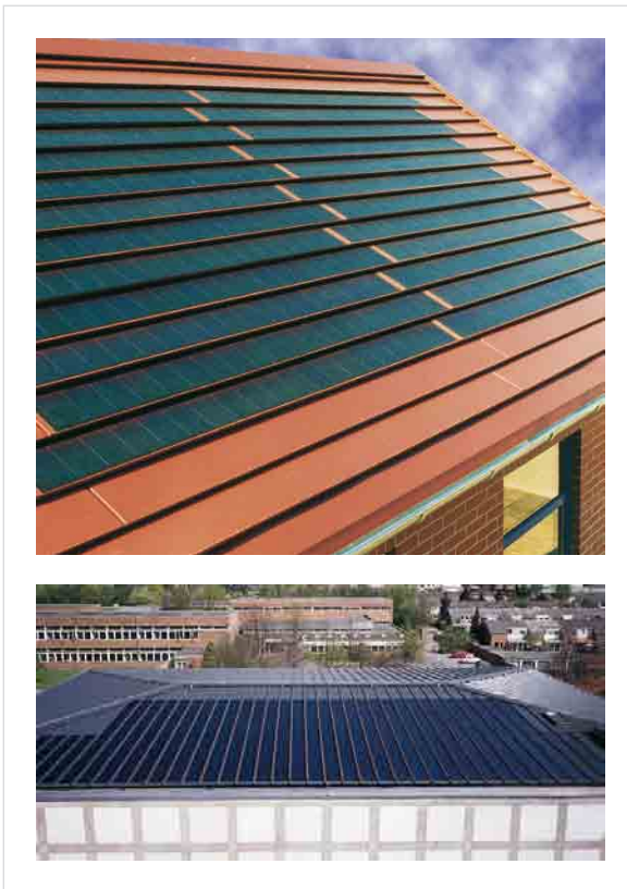
Abb. 4.24: Nur durch die blaue Farbe sind die Solardachziegel von der übrigen Dachbedeckung zu unterscheiden. (Fotos: ThyssenKrupp-Solartec)
