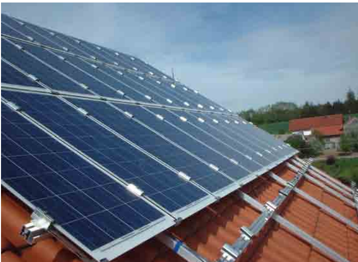
Abb. 4.5: Solargenerator auf kreuzweise montierten Tragschienen. Diese Montageart eignet sich vor allem für sehr unebene Dächer. (Foto: Schletter)
