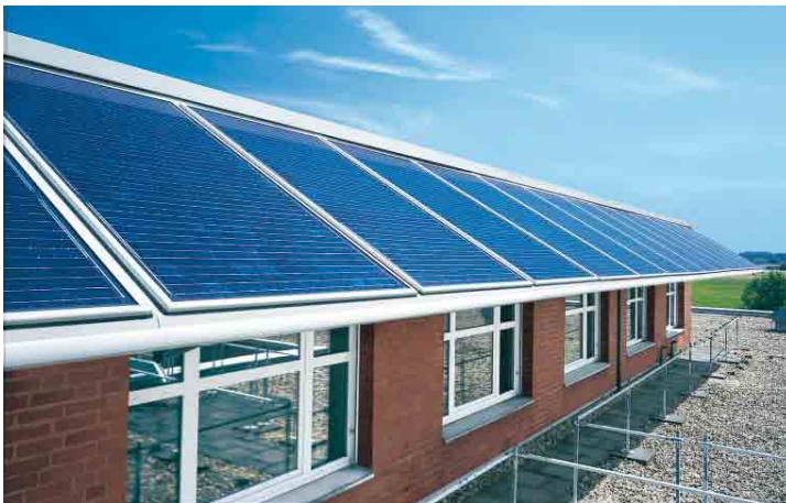
Abb. 4.18: Haus ohne Dachziegel, dafür mit Solarmodulen als Dachbedeckung. (Foto: Schüco)
