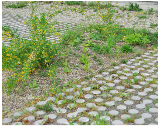
Durch Fugenpflaster versickert Wasser direkt.
