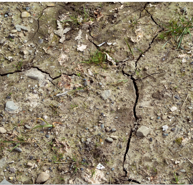
Trockenrisse entstehen auf vegetationsfreien Böden durch Hitze.
