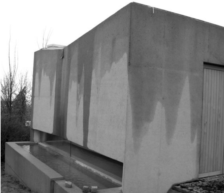
Abb. 1.1–1 Wasserfall auf Sichtbetonfassade
