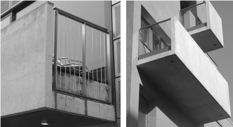
Abb. 1.2.-2 + Abb. 1.2.-3 Betonbrüstung ohne Abdeckung und Gefälle.
