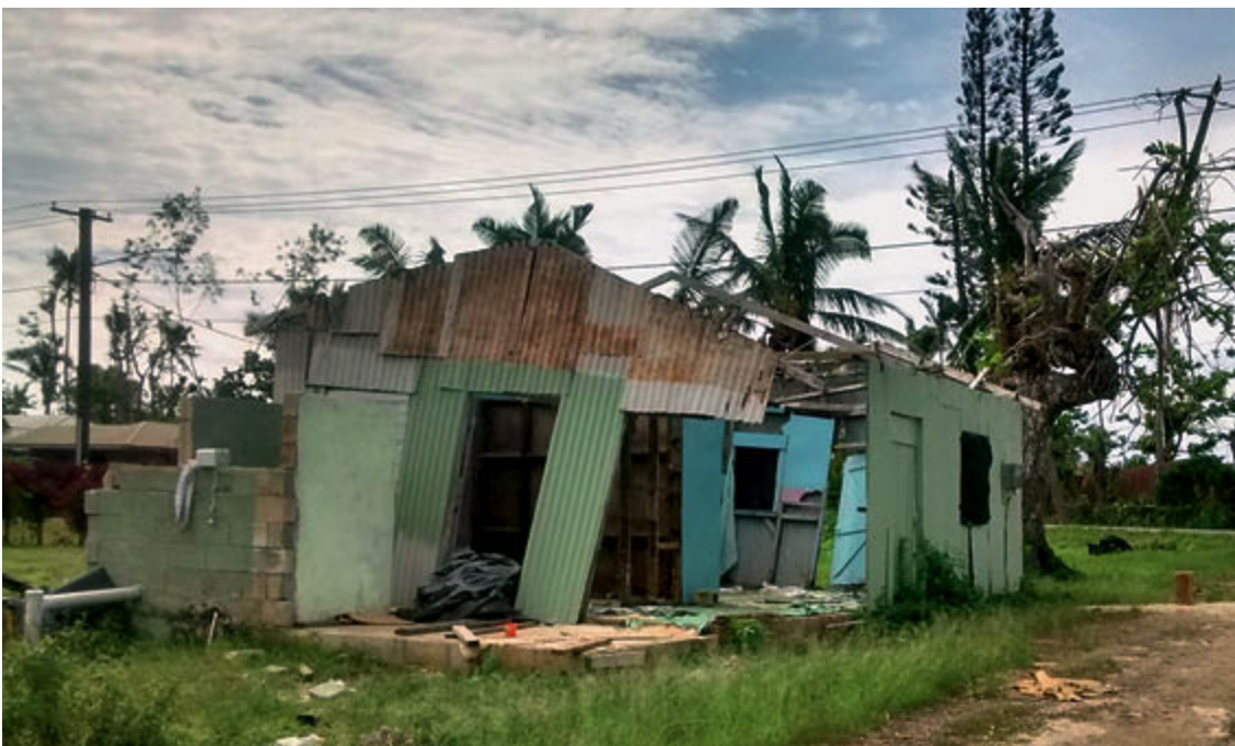
Vom Sturm zerstörtes Haus, Tongatapu, Tonga.
