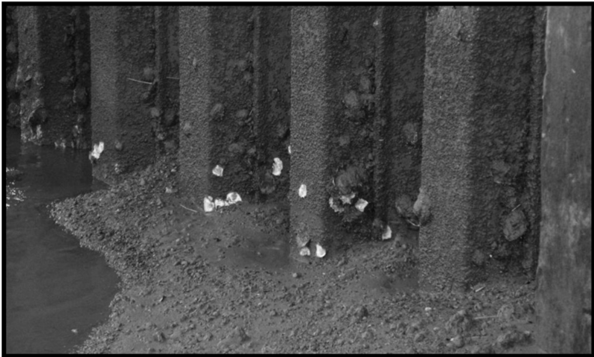
Spundwand eines Hafens mit Austern und Seepocken bei Ebbe
