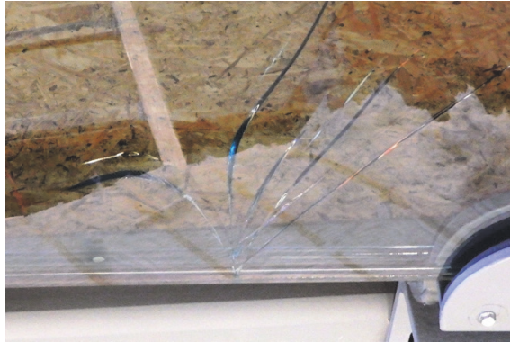
Abbildung 1.2 Typisches Bruchbild bei Versagen infolge thermisch induzierter Spannungen
