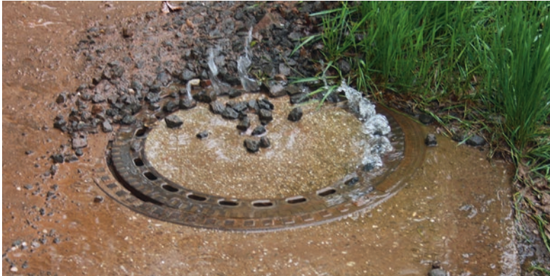
Abb. 1.1 Mischwasseraustritt aus einem überlasteten Kanal über einen Schachtdeckel
