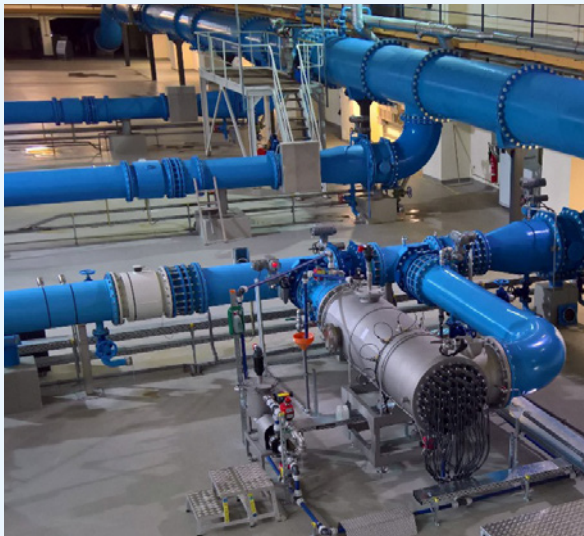
Seite 8: Die Berliner Wasserbetriebe ersetzen in Lindenburg Chlorgas durch umweltfreundliche UV-Desinfektion
