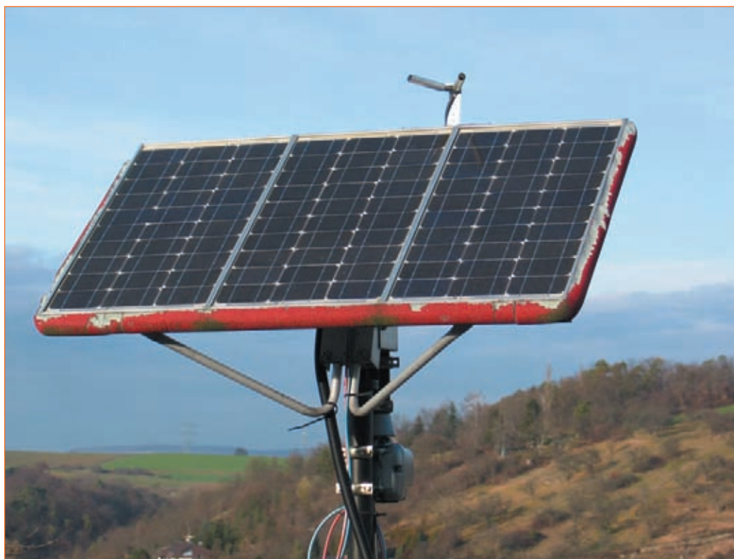
Abb. 74 – Montage auf dem Dach mit einem handelsüblichen Antennenrotor. Beim Solargenerator handelt es sich um drei Module zu je 25 W (parallel), welche ein 12-Volt-Inselsystem mit Kleinverbrauchern versorgen. Oben sind die zwei Röhrchen mit den LDRs für die automatische Ausrichtung zur Sonne zu erkennen.
