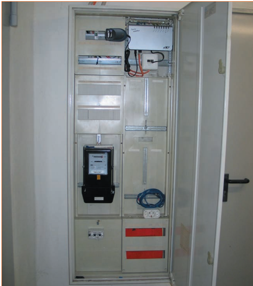
Abb. 5 – Zusätzlicher Sicherungskasten mit montiertem Einspeisezähler. Rechts oben können Sie die Box für die Fernüberwachung erkennen.
