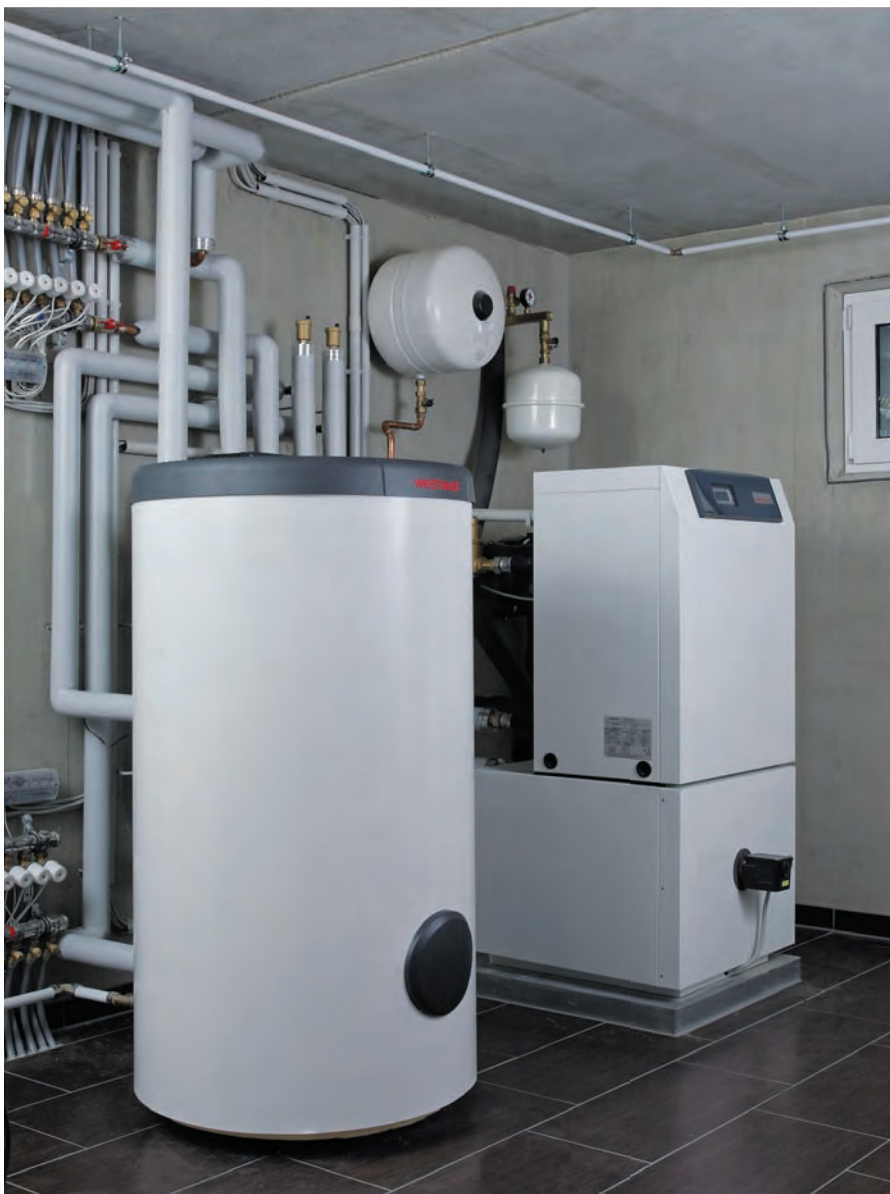
Abb. 3.7: Sole/Wasser-Wärmepumpe mit Trinkwasserspeicher (300 l, links im Bild) (Foto: Max Weishaupt GmbH)
