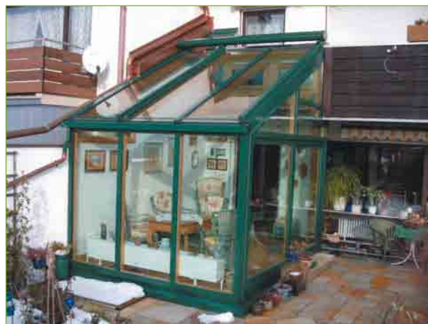
Abb. 3.14 – Kleine Heizkörper am unteren Ende der Fenster. Quelle [1]
