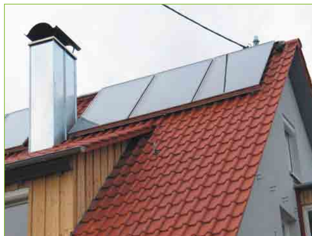
Abb. 3.20 – Sonnenkollektoren für die thermische Unterstützung.
